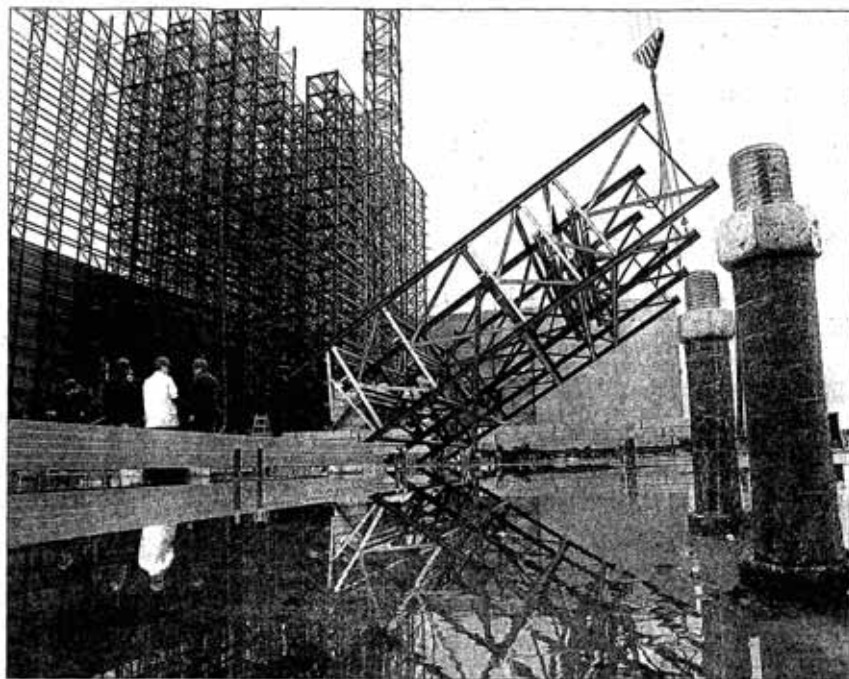
Präzisionsarbeit ist gefordert, wenn der Riesenkran die mächtigen Stahl-Einzelteile für das 40-Meter-Hochregallager in die Höhe
