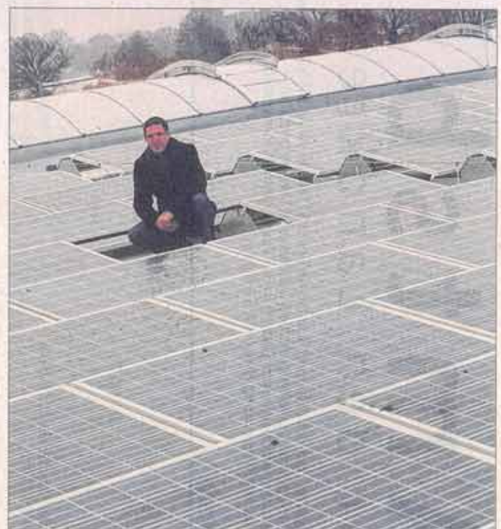
Prokurist Thomas Krieshammer auf dem Dach der neuen Halle, wo eine 5500 Quadratmeter große Fotovoltaik-Anlage Strom erzeugt. Fotos: C. Butt
