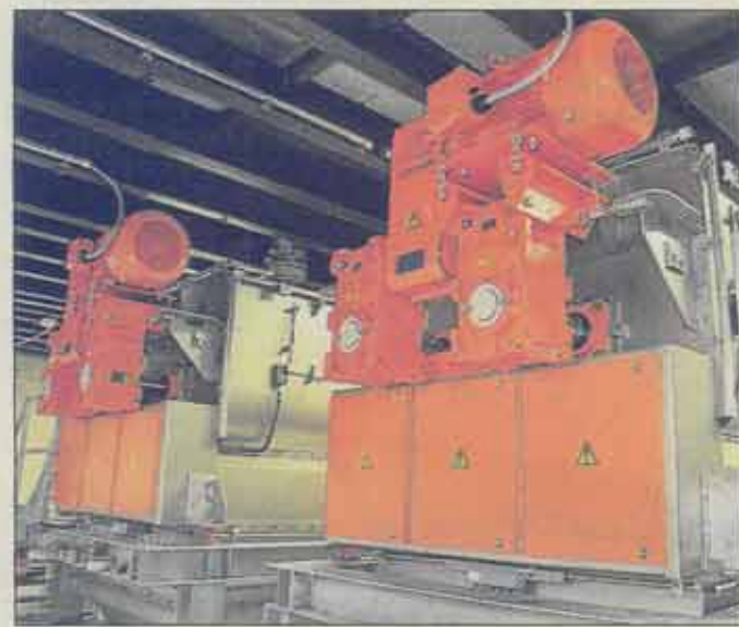
Das Herzstück: Starke Motoren treiben die Mischanlage an.
